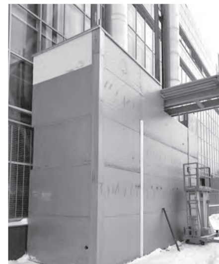
Изолированное оборудование на ломоносовской ТЭЦ.
