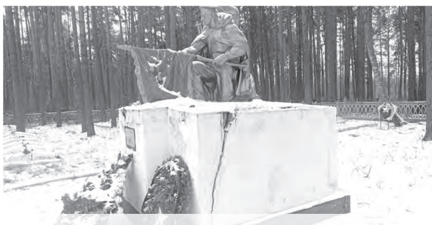
Постамент памятника в Большой Ижоре находится в критическом состоянии.
