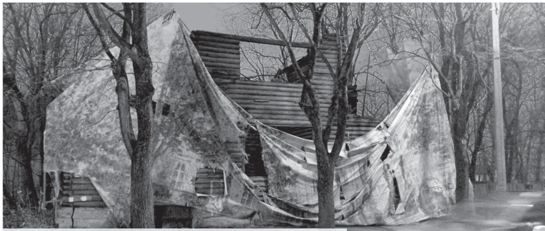
Опасный дом-недострой на улице Владимирская в Ломоносове представляет собой унылое зрелище.
