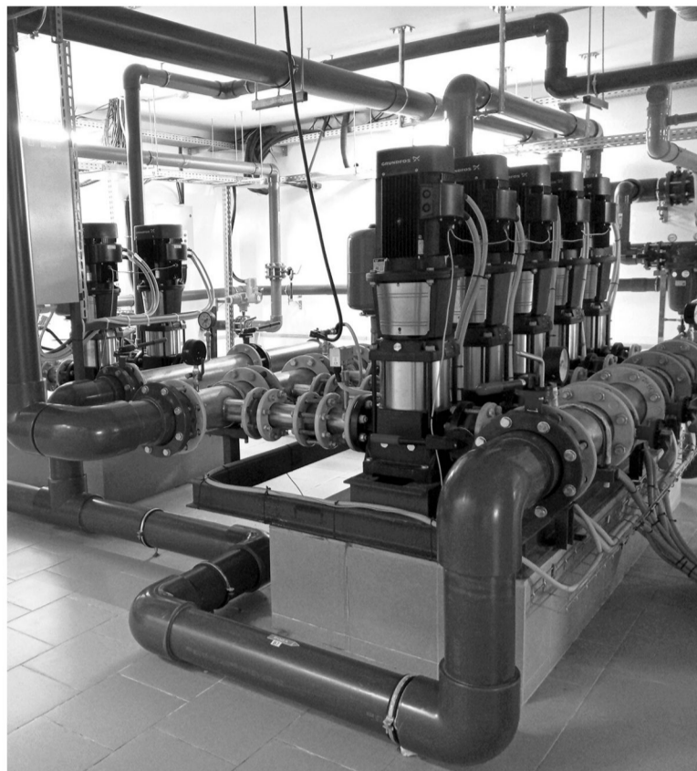
Работу на станции очистки воды контролируют цифровые технологии
